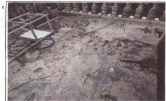
COMENTARIOS: estado inicial de la planilla de piso de la terraza en tercer piso
